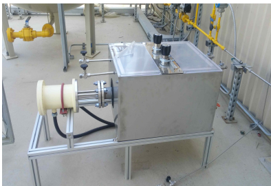
(a) CNG 레귤레이터 히팅장치
