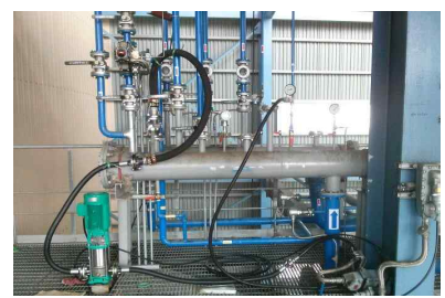
(c) T-Cooler용 냉각수 공급펌프
