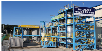
[실증 설비 전경 사진]
