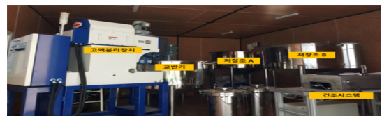
[삼표 시멘트에 구축된 고액분리 건조시스템 전경]
