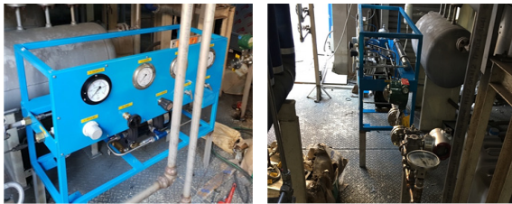
[합성가스 재순환 압축기와 유량계]
