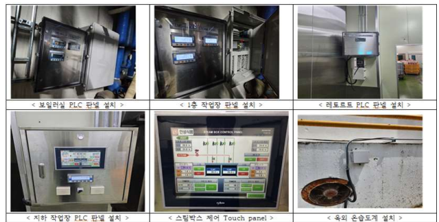
< 식품실증2 계측인프라 구축 전계장 공사 >
