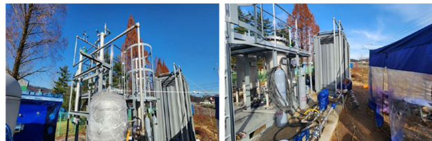
〈 하수처리장 바이오가스 전처리 및 고질화 설비 구축사진 〉
