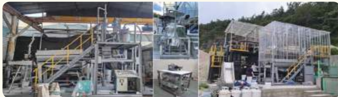
기 설치된 1차 패각소성로에 연계하여 간접가열방식의 2차 소성로 현장설치
